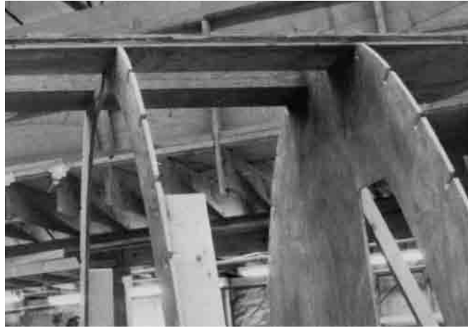
Bild 16.6 – Der lamellierte Kiel der ROGUE WAVE, mit den Rahmenspanten verleimt. Der Kiel ist fertig zum Schmiegen. Der Rahmen im Bereich des Schwertkasten-Ausschnitts bleibt zunächst voll, um ein Verwinden des Kiels während des Beplankens zu verhindern. Der Schwertkasten wird erst nach dem Umdrehen des Bootes eingebaut. In diesem Fall war er außerdem zu groß, um ihn über Kopf einzufügen.
