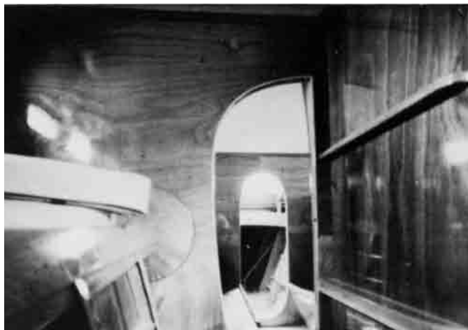
Bild 24.14 – Öffnung in einem Konstruktionsschott der ROGUE WAVE. Der Schwertkasten rechts wurde an das Schott geklebt.
