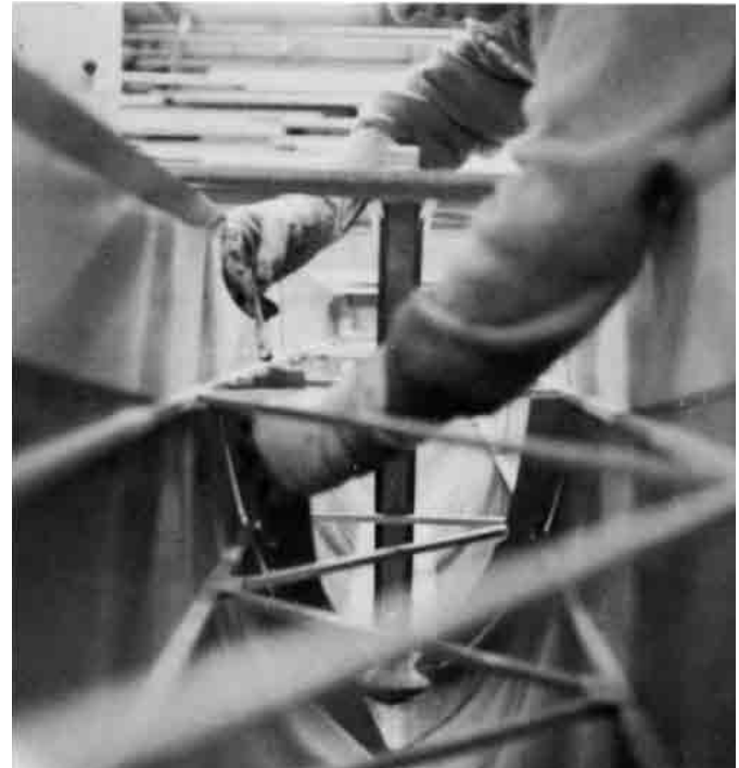
Bild 23.17 – Druckstäbe und Verstrebungen der Zwischenstringer in einem Toruado-Katamaranrumpf. Man beachte die kleinen Sperrholzglaschen, die die Streben mit den Stringern verbinden. Kleine Sperrholz-Halbspanten werden an der Außenhaut befestigt. Diese Spanten werden mit Hohlkehlen an der Außenhaut befestigt. Der senkrechte Pfosten in der Bildmitte ist der Schwertkasten.
